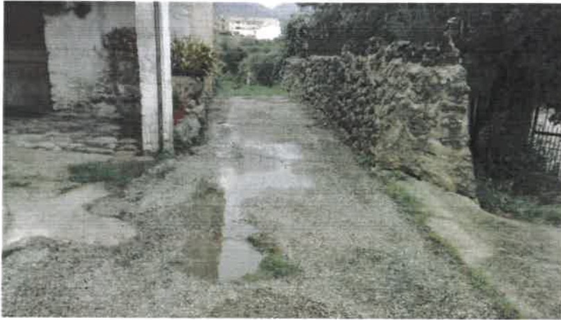
Foto 3: Calle Son Sant Joan – entrada solar nº12. Ancho actual de la calle 1,57 metros, con la pared de cerramiento fuera de ordenación
